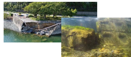
水中ドローンで撮影した被災状況写真
