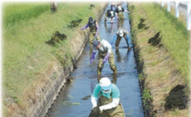
地域住民の清掃活動により水路の機能が維持できています
