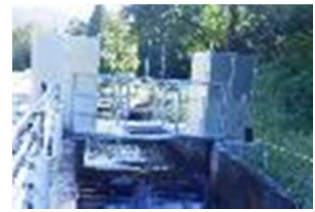
用水路での小水力発電
