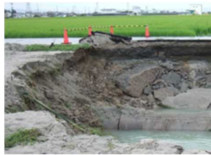
送水管路の破裂事故
