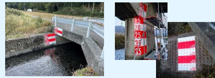
簡易量水標の設置状況
