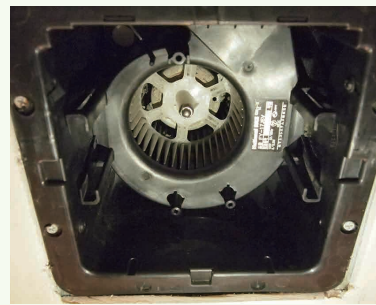
清掃後の換気システムのファン
