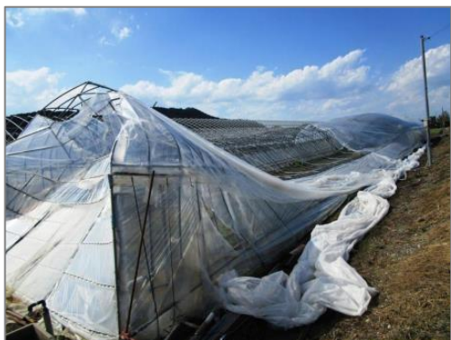
⑤ ビニールハウスの倒壊
