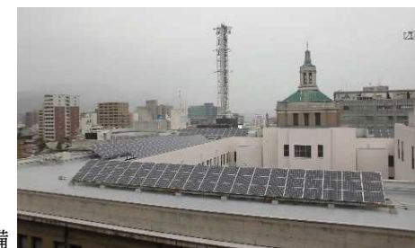
※県本庁舎における太陽光発電設備
