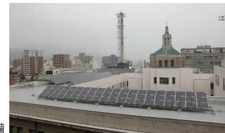
※県本庁舎における太陽光発電設備
