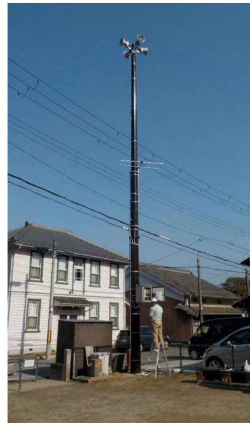
同報系屋外放送設備 写真
