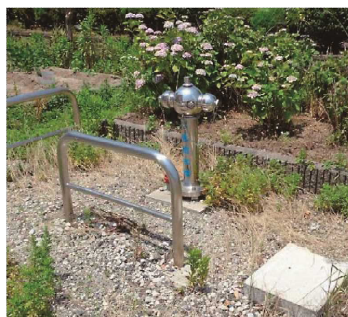
守山市応急給水栓
