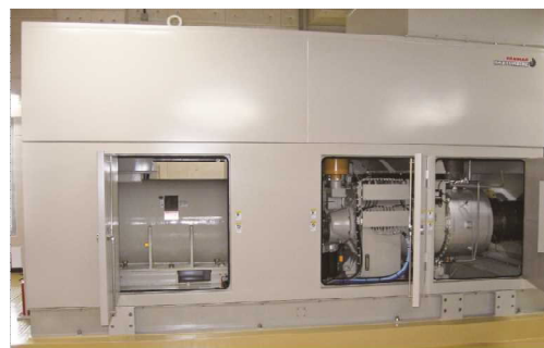
吉川浄水場 2,500KVA
