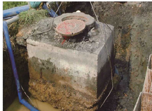
空気弁丁子管から漏水
