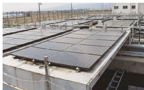
太陽光パネル
