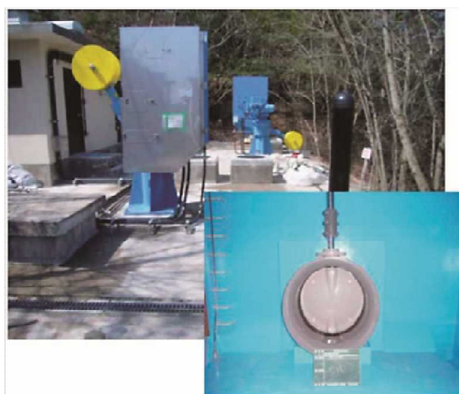
山脇調整池緊急遮断弁
