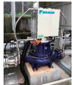
管水路用マイクロ水力発電システム（近江八幡市長福寺町）
