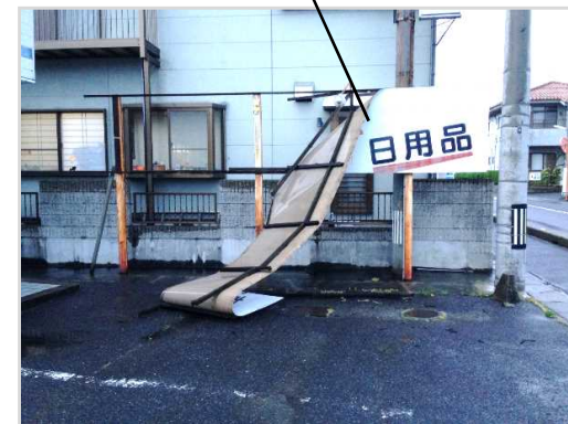
老朽化や強風等により破損した広告物
