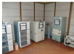
測定局の内部
