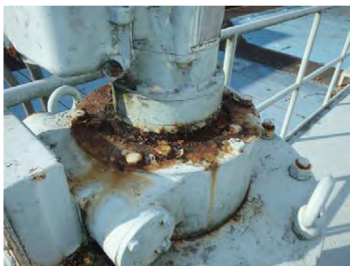
図 2. 湖南中部浄化センター No.1 汚泥掻寄機(腐食)
