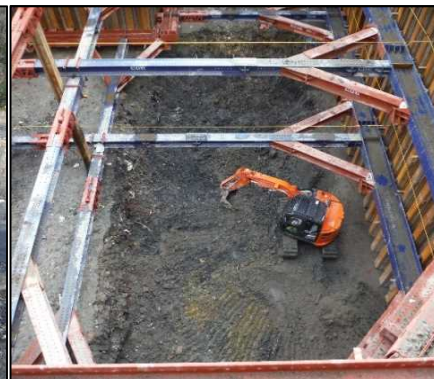
② 有害物掘削工 C区画の有害物掘削を行っています。
