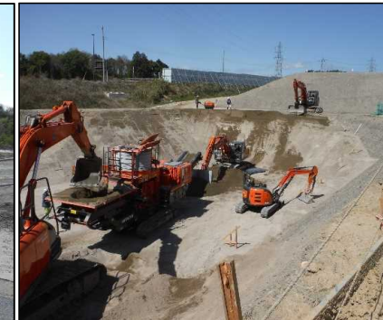
③ 洪水調整設備工
