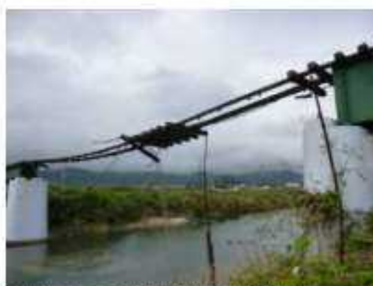
柳川に架かる信楽高原鉄道橋脚流出 （甲賀市）
