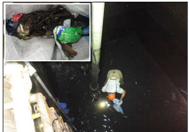
図-4 ピット内の清掃状況と流入したゴミ類
