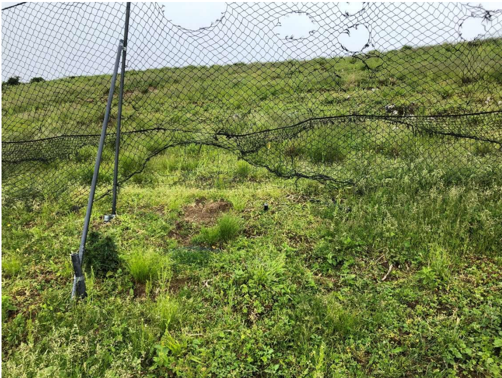
東登山道エリア植生防護柵のダメージ （下半分が大きく開いている）
