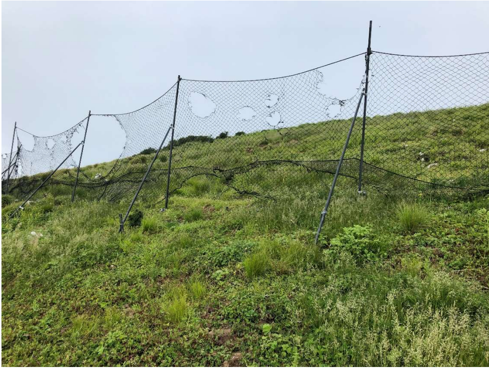
東登山道エリア植生防護柵のダメージ （大きな穴がいくつも開いている）
