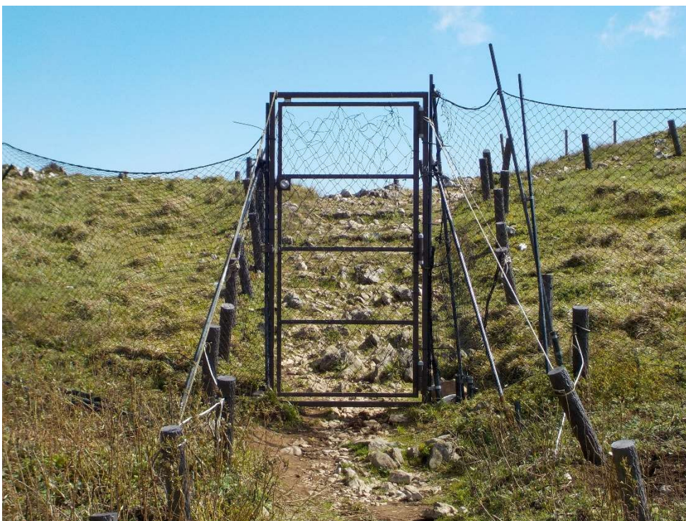
倒壊したゲートの回復 （上野区が実施）
