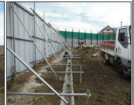
⑤ 雨水排水工 国道側U字溝の据付を行っています。
