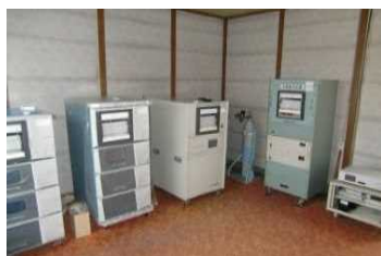
測定局の内部
