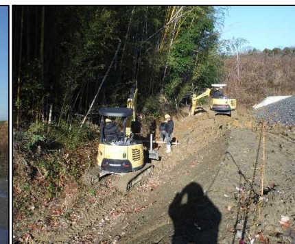
⑤ 雨水排水工 側溝を設置するための掘削を行っています。
