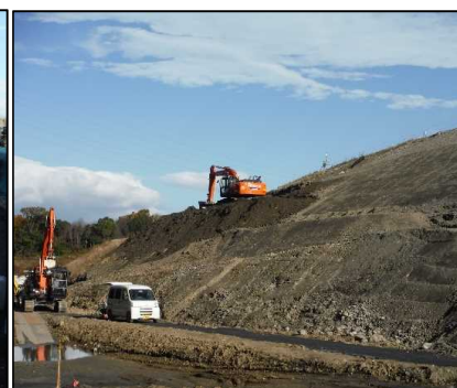
② 選別土仮置・盛土工 C工区の法面整形を行っています。
