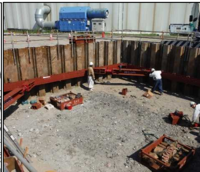
① 有害物掘削工 E区画の支保工を設置しています。
