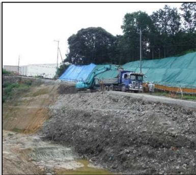
① 有害物掘削工 I区画の廃棄物土掘削を行っています。
