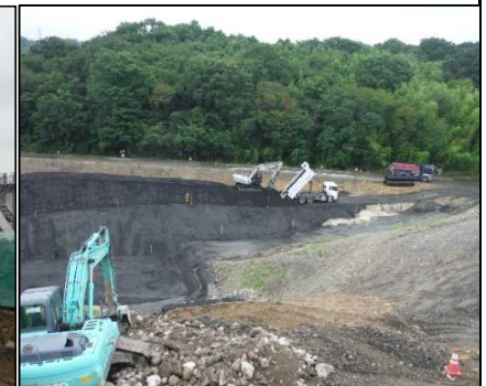
④ 底面・側面遮水工 D・E工区底面遮水工材料をストックして います。
