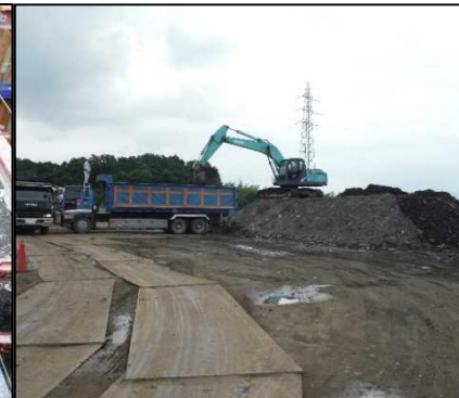
② 有害物掘削工 仮置きした有害物土を外部搬出しています。
