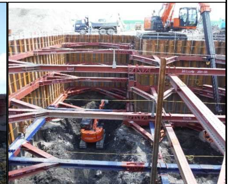
② 有害物掘削工 FG区画の四次掘削を行っています。
