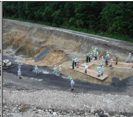
①-1 D・E工区掘削 地山確認の現場見学会状況です。
