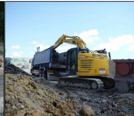
② 有害物掘削工 E区画全旋回置換部の有害物を外部搬出しています。
