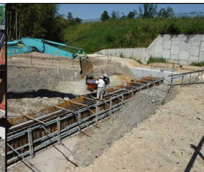
⑥ 洪水調整設備工 接続管の巻き立てコンクリートを打設しています。
