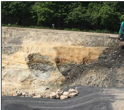
①-1 DE工区掘削(撮影日: 令和元年5月17日) E工区(西側)の廃棄物土掘削を行っています。地山が確認できた範囲は掘り止めとしています。今後、安全な作業を行うため、埋戻しを行いますが、掘削状況は次回の連絡協議会で報告いたします。
