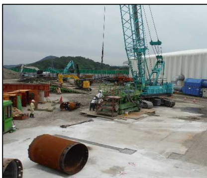
② 有害物掘削工 E区画の全巡回掘削(既設杭部)施工準備を行っています。
