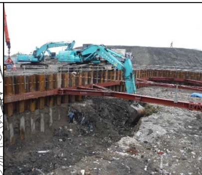
② 有害物掘削工 FG区画廃棄物土を掘削しています。
