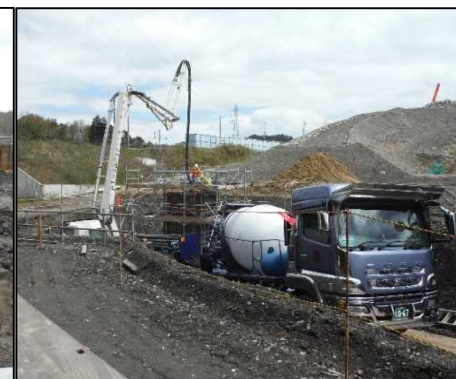
⑥ 洪水調整設備工 オフィスタワーのコンクリートを打設しています。
