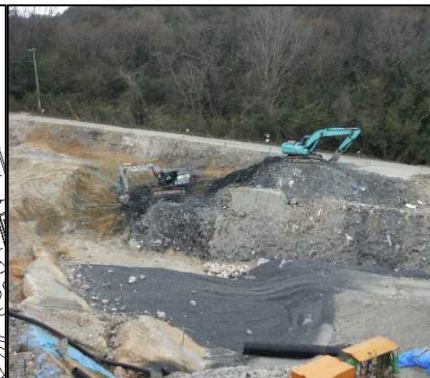
①-1 D・E工区 E工区西市道側を掘削しています。
