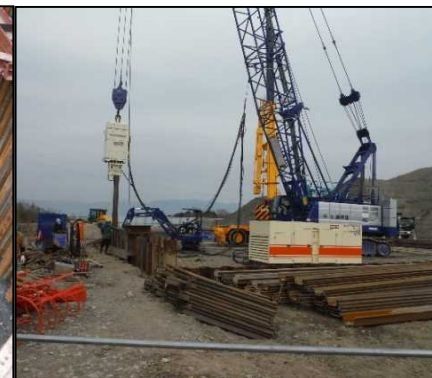
② 有害物掘削工 FG区画の鋼矢板打設を行っています。
