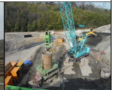
⑤ 底面・側面遮水工 全回転機にて掘削を行っています。
