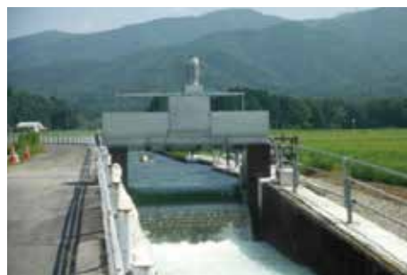
農業用水路の落差を利用した小水力発電 (長浜市湖北土地改良区)
