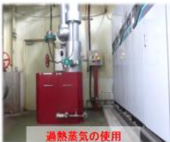
過熱蒸気の使用
