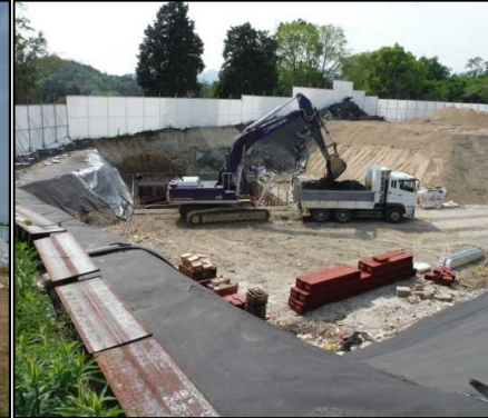
②有害物掘削除去工 A-1区画の廃棄物土を掘削しています。
