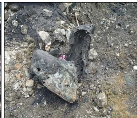
②有害物掘削除去工 B区画にて、穴の開いたドラム缶が1個出てきました。密閉容器に保管しました。
