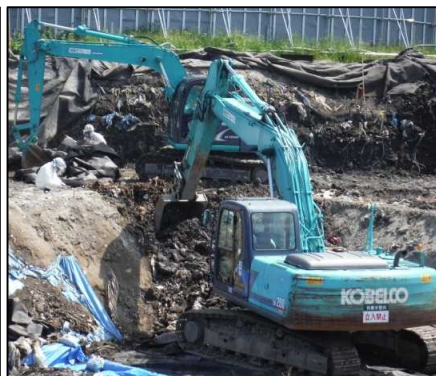
②有害物掘削除去工 B区画の有害物土掘削を行っています。
