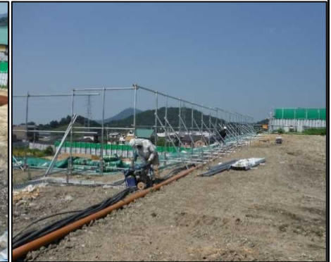
④ 環境対策設備工 国道バイパス側の仮囲いを設置しています。
