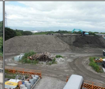
③ 選別土仮置・盛土工 分析を行い、問題の無い選別土を場内に仮置きしています。
