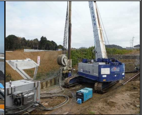
③ 矢板工 下流部止水矢板の圧入を行っています。 (11月21日に打設が完了しました。)
