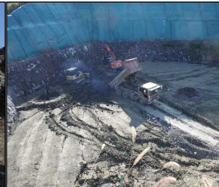
②-2 A工区埋戻し A工区を選別土で埋め戻しています。
