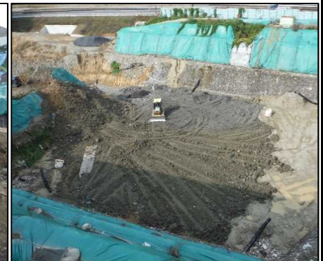
②-2 A工区埋戻し A工区の埋戻しを行っています。
