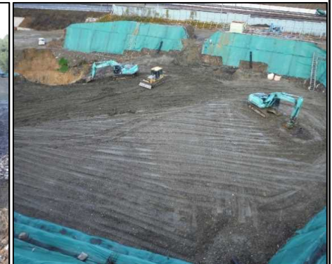
②-2 A工区埋戻し A工区の埋戻しを行っています。
