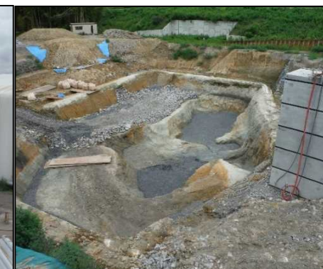
⑥ 底面・側面遮水工 底面遮水工の準備をしています。
