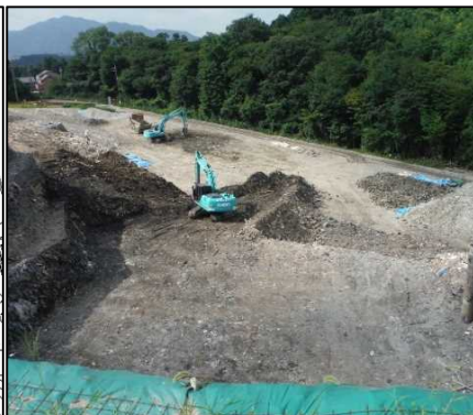
② 有害物掘削工 H-2区画施工のために進入路を造成しています。
