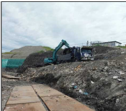
①-1 D・E工区、H区画掘削 D工区廃棄物土を掘削しています。
