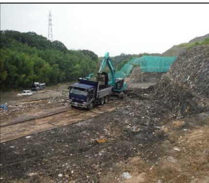
①-1 C・D・E工区、H区画掘削 E工区廃棄物土を掘削しています。
