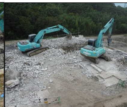
④ 構造物撤去工 ブレーカーで土間コンクリートを取り壊しています。
